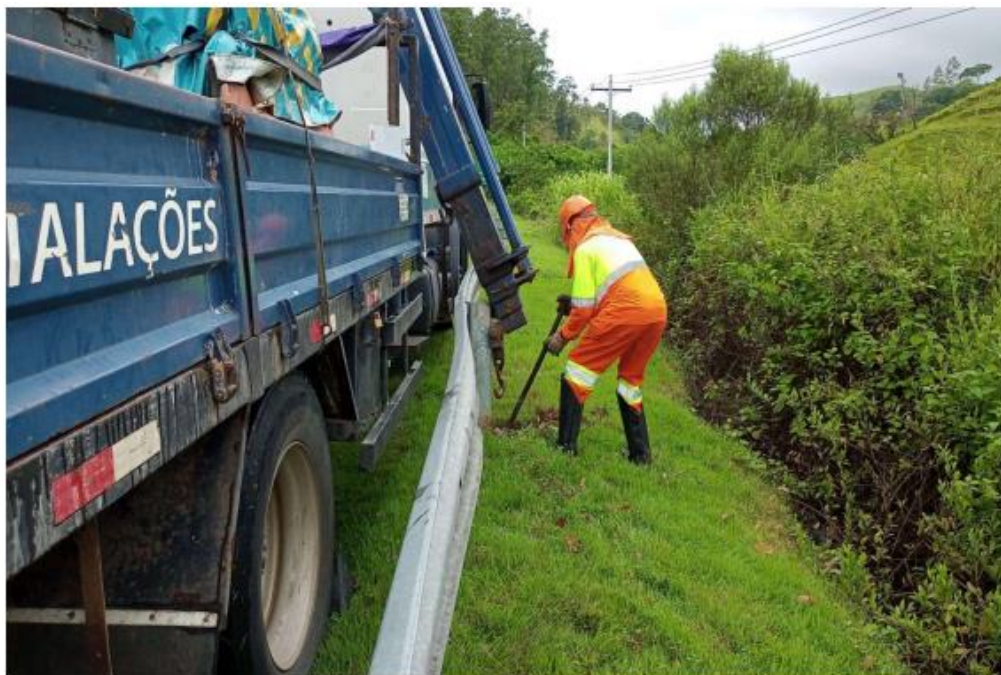
Figura 4-3 Via Lagos - Dispositivo de Segurança - Km 6+900 Sul
