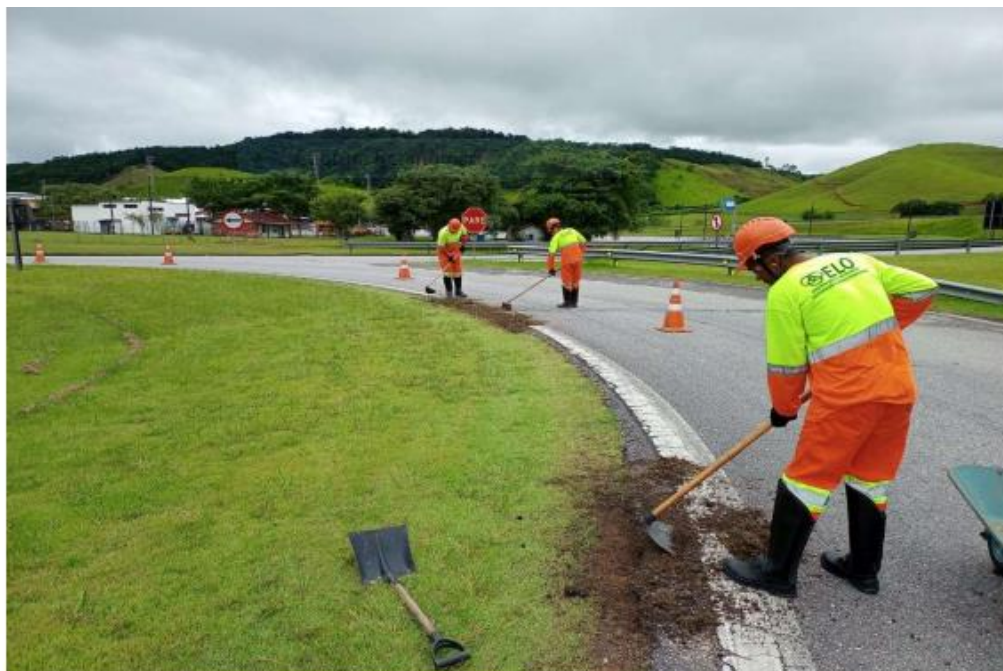
Figura 4-8 Via Lagos - Refilamento de Bordo - Km 21+500 Norte
